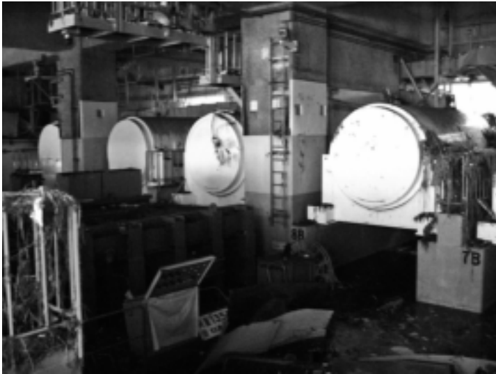
第 4 図 「3・11」後の福島第 1 原発の乾式貯蔵キャスク保管建屋内の状況 (出所) 東京電力株式会社 HP: http://photo.tepco.co.jp/date/2011/201109-j/110909-02j.html
