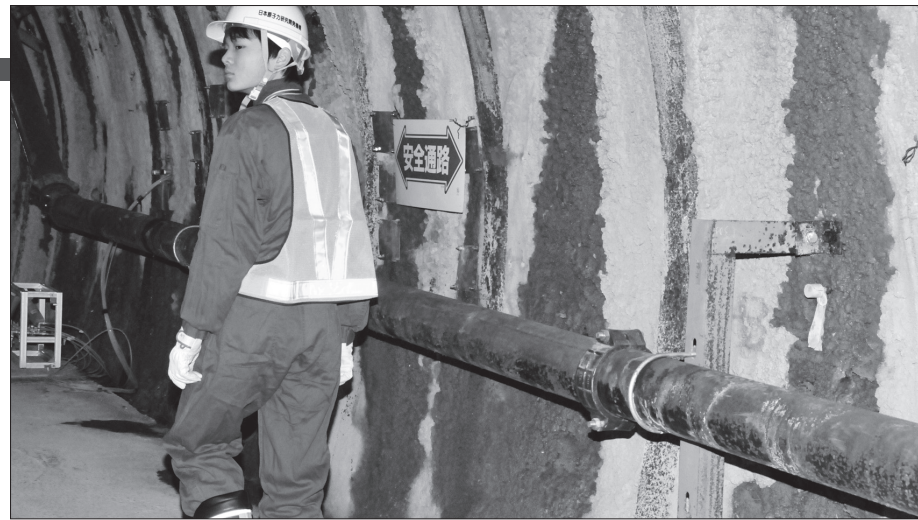
坑道には厚さ20～40cmのコンクリートを吹き付けてあるが、地下水がにじみ出て黒く写っている（幌延深地層研究センターで）
