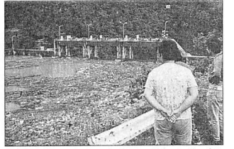
土砂とゴミで埋まった北電の岩知志ダム(日高町内の沙流川)
